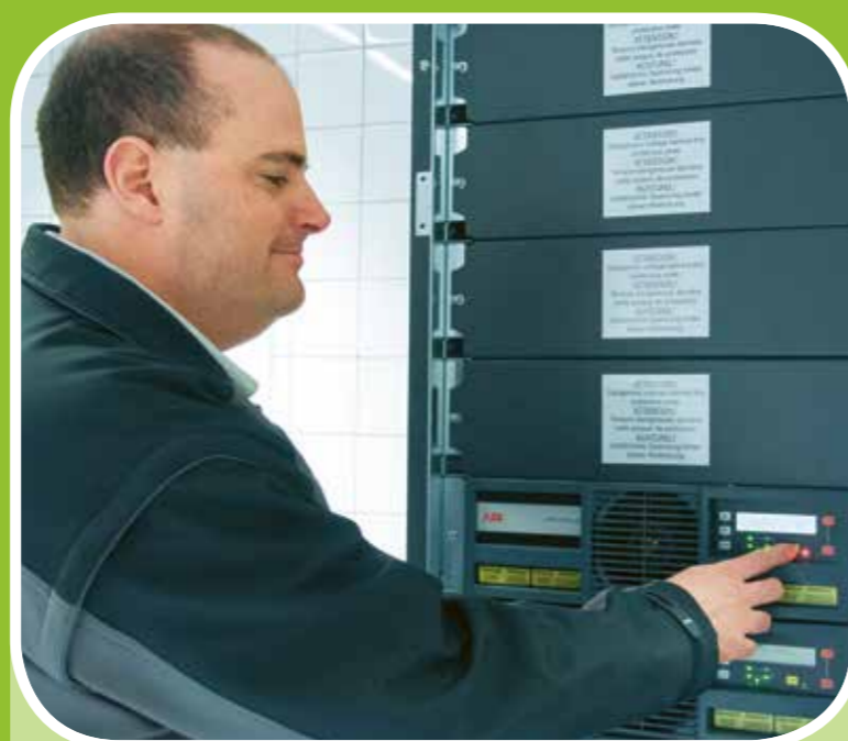
Stefan Zimmerli checkt den technischen Alarm einer USV-Anlage.
